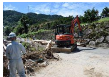
現場パトロール 佐賀(台風による土砂崩壊現場)
