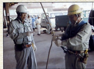
現地KYの実地体験 *ひとりー人がこれから作業する現地で設備や工具類等を点検・指差呼称しながら、危険を予測し対策を立てて、災害を防止します。
